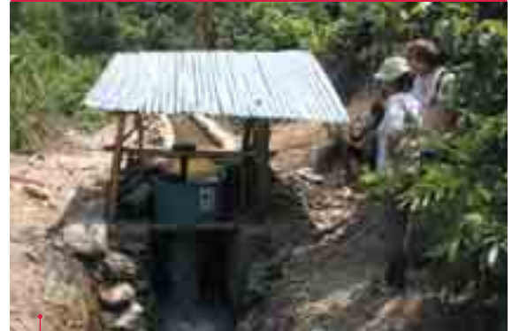
Pico-turbine de 1 000 W Source : Électriciens sans frontières
