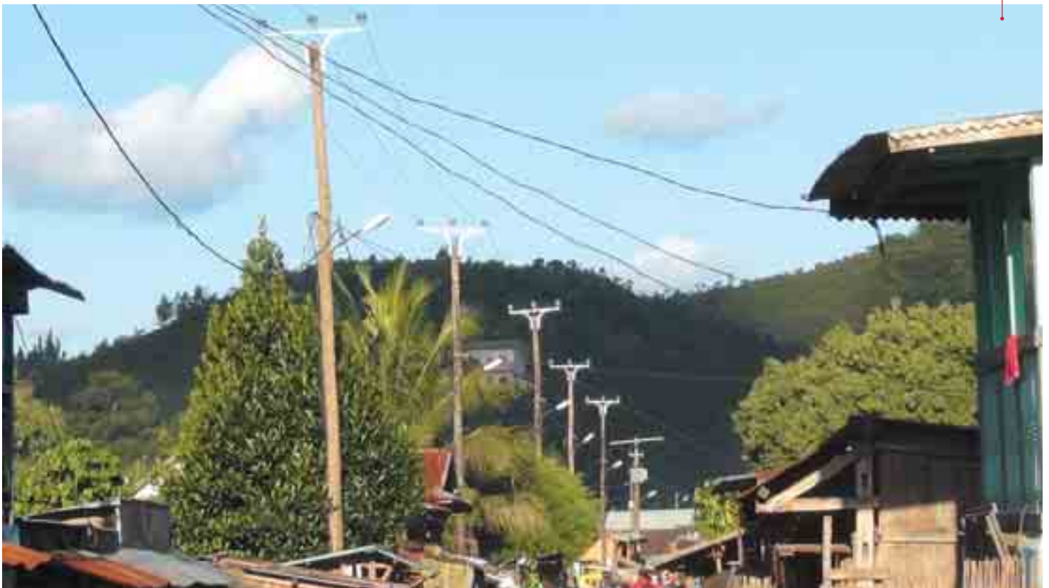
Réseau électrique du village de Tolongoïna - Source: GRET
